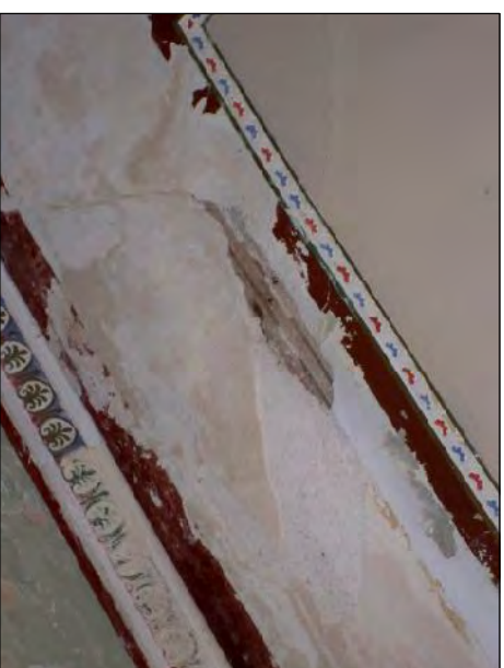
Φ. 7 Β' όροφος. Καταστροφή οροφολοφών και τοιχογραφιών
