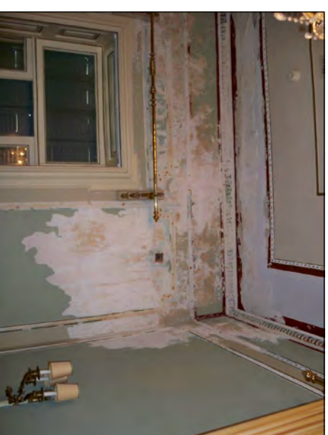
Φ. 6 Β' όροφος. Καταστροφή οροφολοφών και τοιχογραφιών
