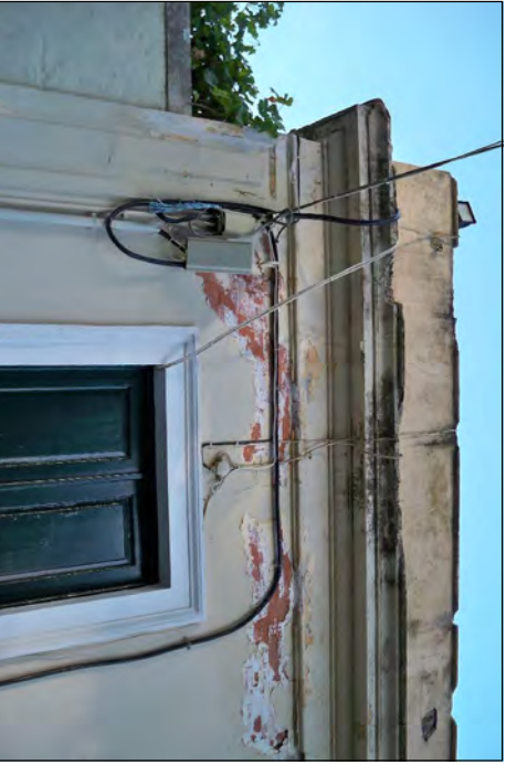
Φ. 4 Κατεστραμμένα επιχρίσματα και ρυγίλες
