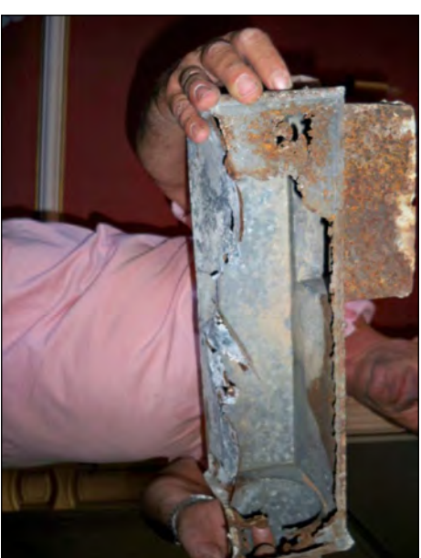
Φ. 3 Κατεστραμμένη εσωτερική υδρορροή
