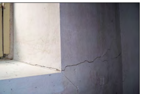
Φ7. ΧΩΡΟΣ 6, ρωγμή στη θύρα εισόδου
