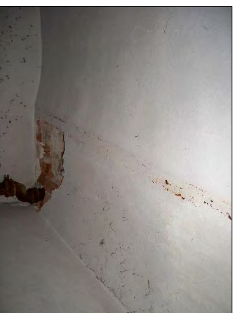
Φ. 8 Β' όροφος. Διάβρωση σιδηροδοκίων πατώματος
