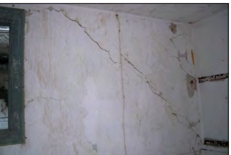
Φ9. ΧΩΡΟΣ 8γ, ρωγμές στην τοιχοποιία
